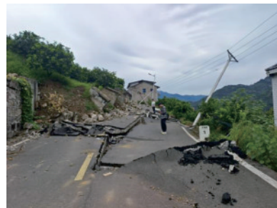
图10 左侧前部挡土墙及路面变形
