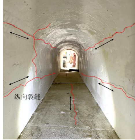
(c) 站台结构裂缝
