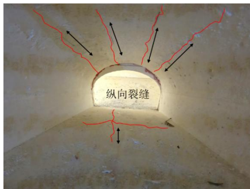
(b) 竖向联络通道结构裂缝
