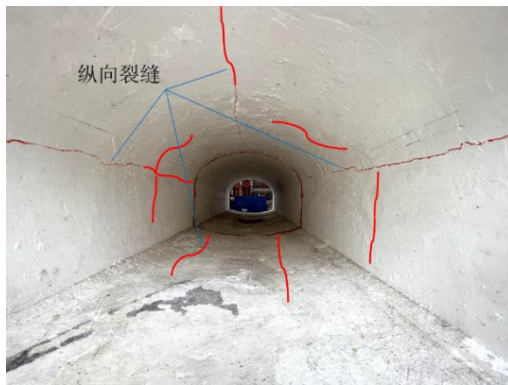
(a) 站厅结构裂缝
